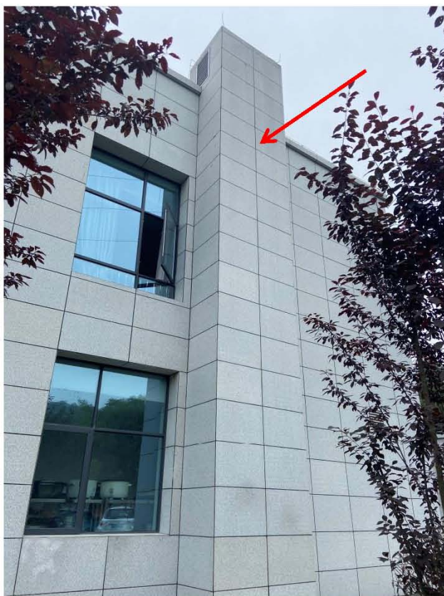
图 3-3 项目食堂油烟排气筒
