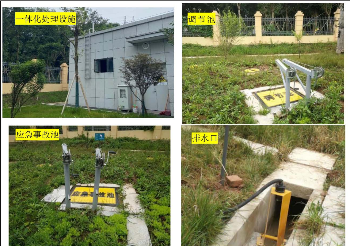
图 3-2 项目污水处理设施
